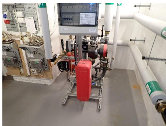
Undercentral för värme och varmvatten
