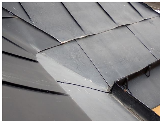
Yttertak med mindre skador från snöskotning
