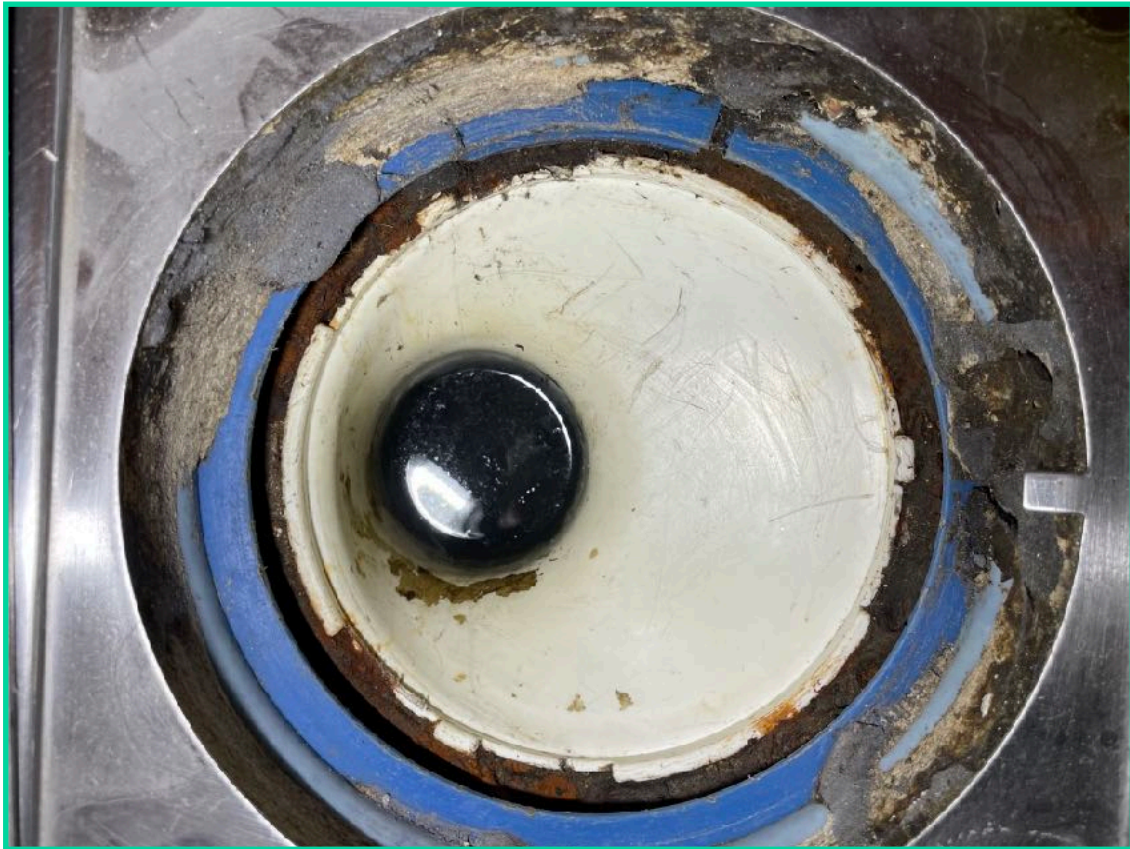
Äldre golvbrunn av gjutjärn, kraftigt korrosionskadad.
