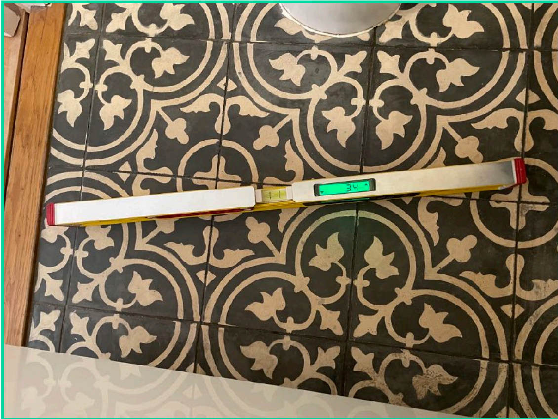
Golvlutning överstigande 10 mm/m mellan WC och tvättställ.
