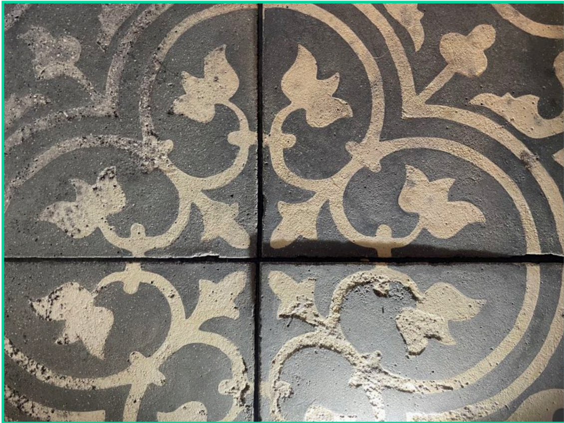
Kraftigt eroderade cementplattor.
