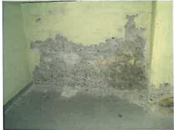
Fuktgenomslag grundmur elrum
