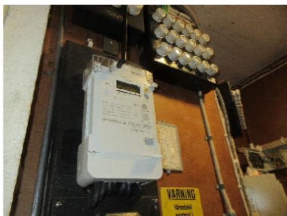
Gamla elektriska installationer
