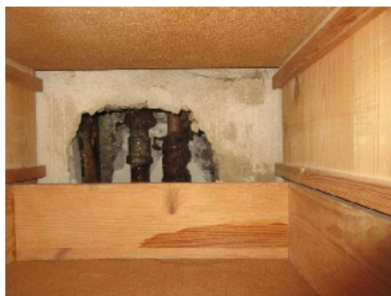
Pågående läckage på kallvattenröret
