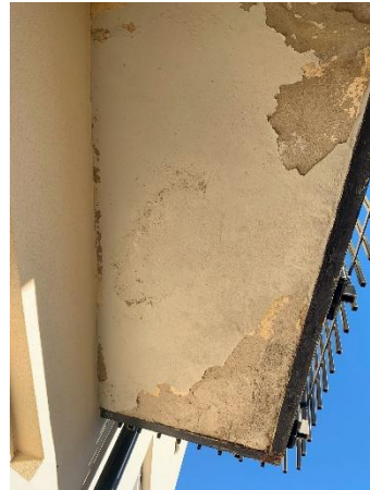
Balkong med delar som lossnar.
