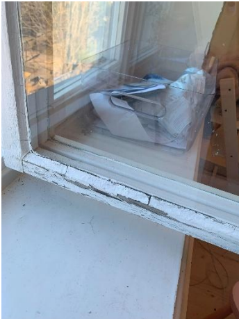
Fönster med färg som lossnar.
