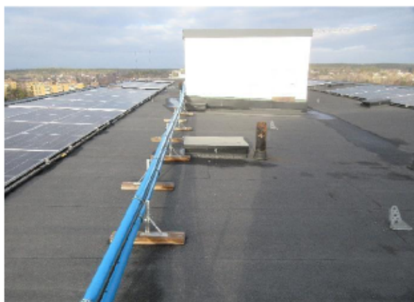
Yttertaket med solceller och värmeåtervinning
