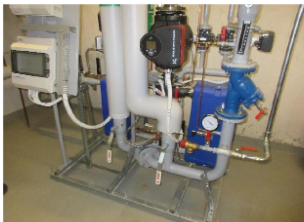
Fjärrvärmecentral för värme
