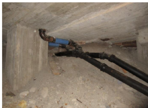
Avloppsrör i krypgrunden
